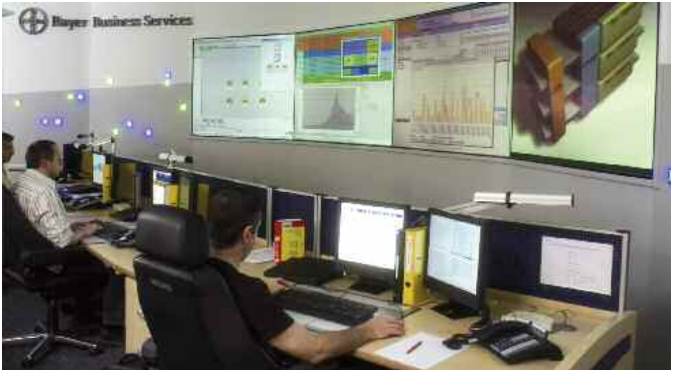
▲ Anlagenüberwachung und -steuerung (Foto: Bayer)
